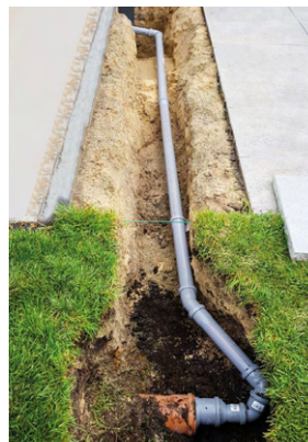
Regenrohr Anschluss unsichtbar im Boden
